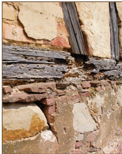
Forte dégradation de la sablière
