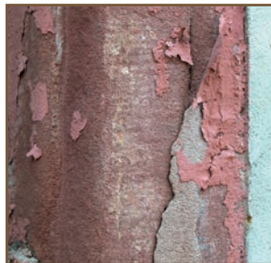
Décollement de la peinture sur une pierre de taille
