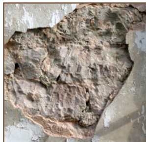
Décollement de l'enduit sur un mur de moellons
